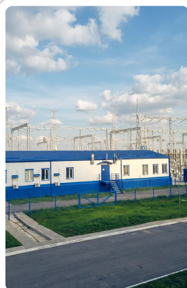
ПС 220 КВ ЧАПАЕВСКАЯ, САРАТОВСКАЯ ОБЛ.
