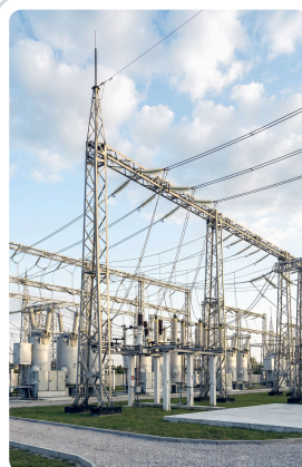
ПС 220 КВ КЕМЕРОВСКАЯ, КЕМЕРОВСКАЯ ОБЛ.
