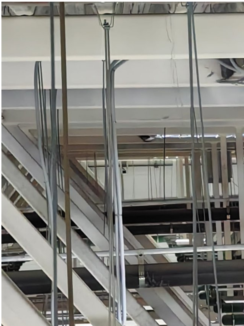
Рисунок 5 – Конструктивные элементы (шпильки), фиксирующие подвесные элементы к потолку.
